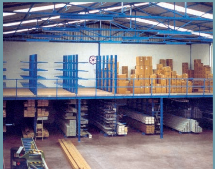
Mezzanine comme étage intermédiaire avec des systèmes de rayonnages à bras portants. En haut stockage de marchandises en paquets et systèmes de rayonnages partiels.
